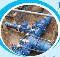
Canalisations d'eau potable
