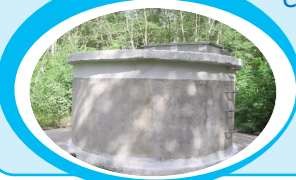
Puits de captage pour puiser l'eau des nappes souterraines du Coteau
